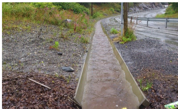
Betongrenne for overvann langs Hordnesvei.
