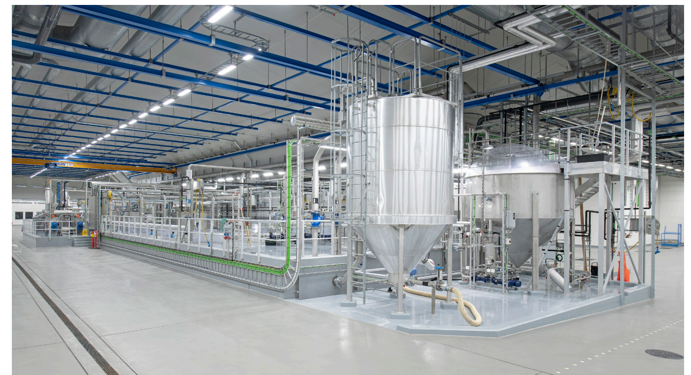
Kvernevik avløpsrenseanlegg. Etter grovristen, der alt boss blir fjernet kommer avløpsvannet hit til fett- og sandfanget. Her fjernes fett og sanden. Fettet samles i tankene på enden av prosessen. (Foto, Helge Skodvin)
