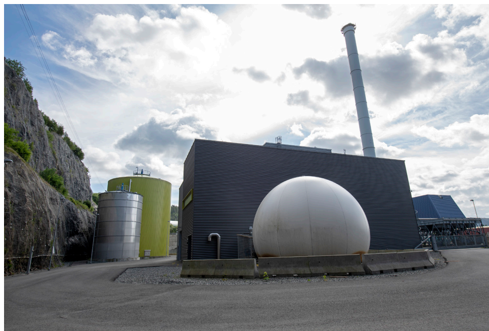
Gassklokken i front og råtnetankene bak til venstre på biogassanlegget. (Foto, Helge Skodvin)
